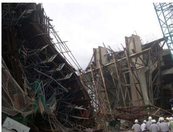
Vòm cầu giữa trụ P15 và P14 sập đổ (Ảnh: Tiền Phong)
