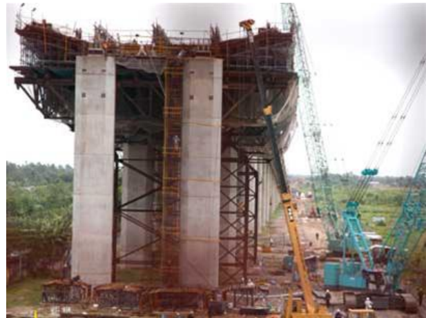
Hai vây cầu đang được thi công (Ảnh do Tuổi Trẻ chụp ngày 1 tháng 8 năm 2007)
