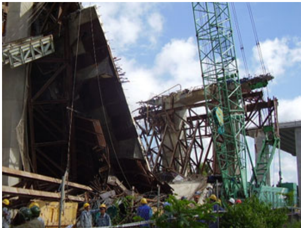
Vòm cầu giữa trụ P14 và P13 sập đổ (Ảnh: Tiền Phong)
